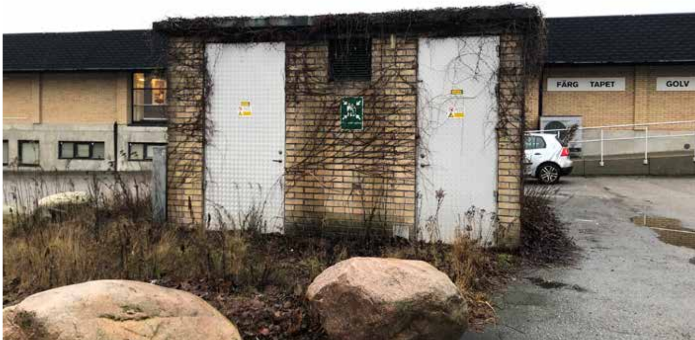
Hällbo 11, befintlig transformatorstation
