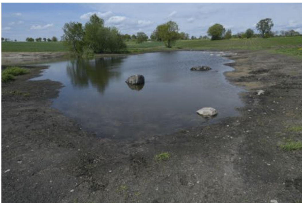
Figur 10. Färdigställd våtmark i västra diket, vid sektion V3/V4. Notera markfasta block och svämsediment som exponerats i kanten av den historiska våtmarken som restaurerats.
